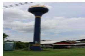
ถังเก็บน้ำ หอส่งน้ำ(ประปา s.s.) ปีที่สร้าง 2561
